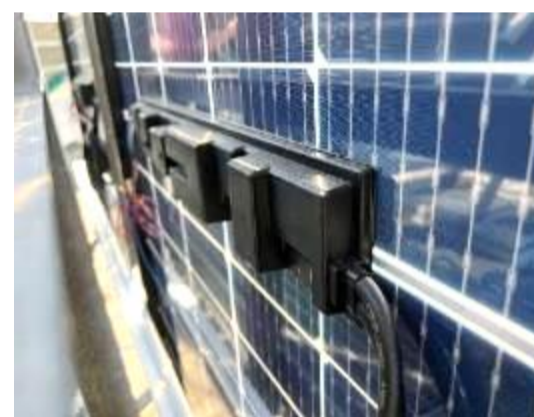
Vergossener Mikro-Wechselrichter auf der Rückseite eines PV-Moduls. Quelle: Tobias Brinker, IAL-LUH
